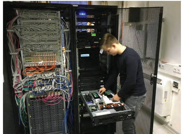
Serverraum in der BAV
